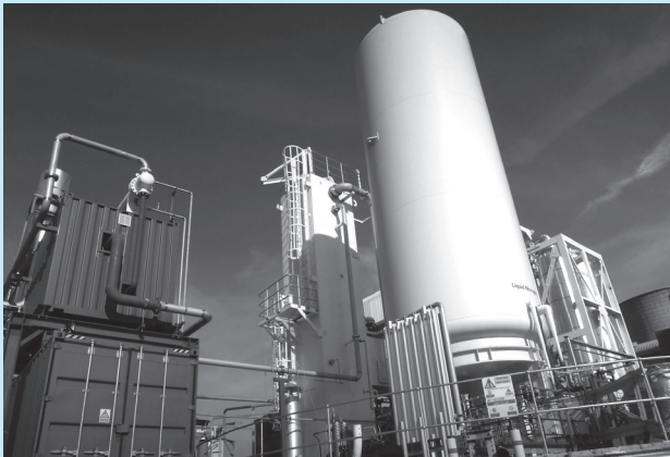
그림 1 350kW/2.5MWh 파일럿 플랜트(영국, 슬라우)
